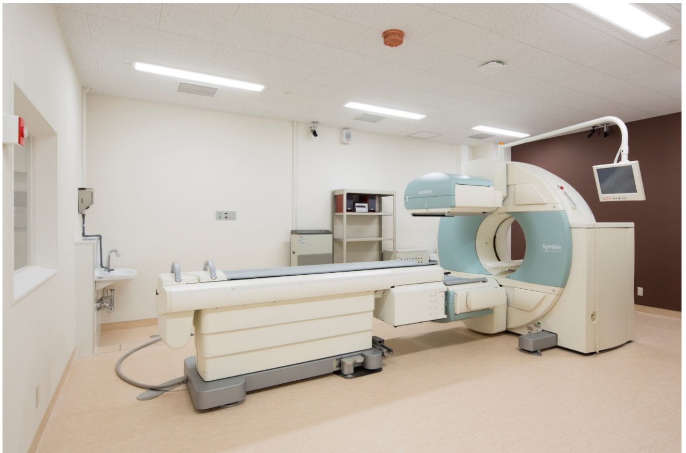
本館地下1階RI検査室
