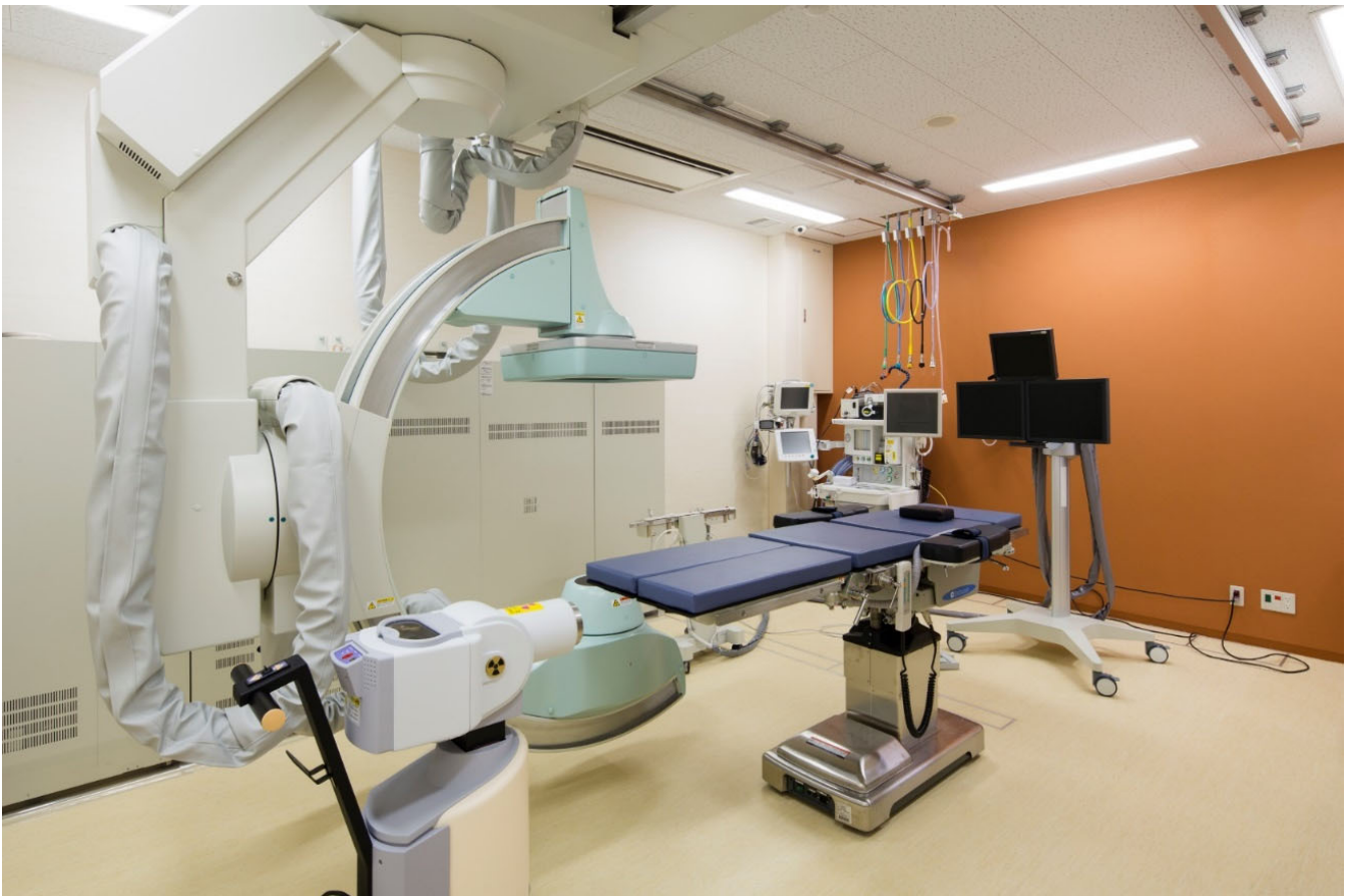
本館地下3階小線源治療室
