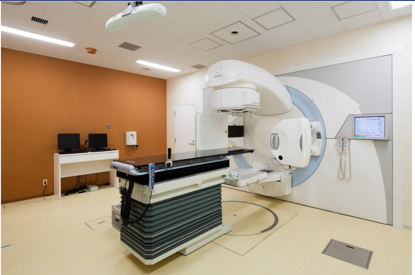
本館地下3階放射線治療室
