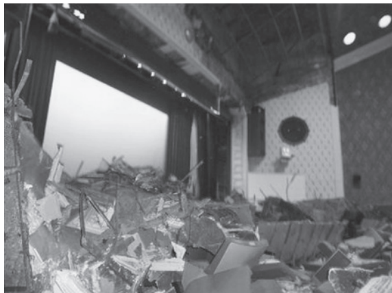
写真1 九段会館内天井崩落現場
