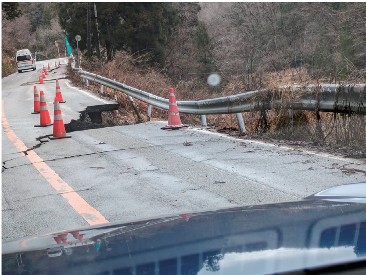
図2 国道249号線の状況
